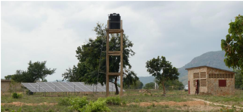
Solaranlage, Wasserturm und Technikhaus
