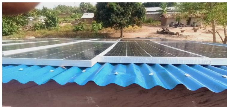
Solarstrom für die Maismühle
